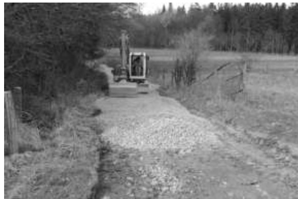
Abb. 17: Um das Überfahren wertvoller Flächen zu unterbinden, musste am NSG „Räuschenberg“ sogar ein Stück Weg instand gesetzt werden (Foto: D. KRÄMER).
