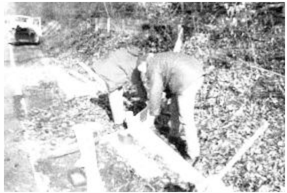
Abb. 27: Reparatur des Amphibienzauns bei Bühne am 08.03.2004 (Foto: LSHX)
