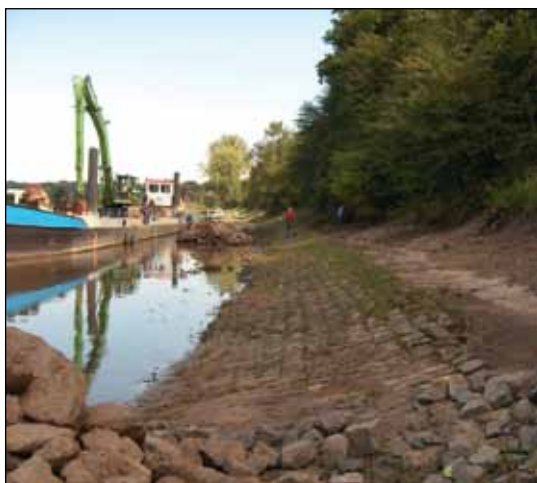
Abb. 6: Rückbau eines Deckwerkes bis zur Mittelwasserlinie am Matzwerder (Elbe-km 249,4 - rechte Elbeseite) während der Maßnahme. Foto: A. Regner.
