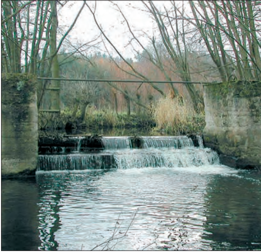
Abb. 1: Wehr Wippra / Wipper. Die ökologische Durchgängigkeit für Fische und Makrozoobenthos ist nicht gegeben. Foto: C. BRÄUNIG.
