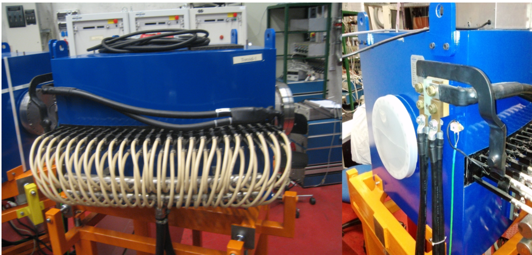
Abbildung 5.2: Links: Seitenansicht eines Toroidsegments: Zu sehen sind die Kühlanschlüsse der einzelnen Pancakes und die beiden Stromanschlüsse an diesen auf der linken und rechten Seite / Rechts: Hauptstromanschluss des Magnets: Zu erkennen sind die beiden Verbindungen die zu den Pancakes gehen und das abgedeckte Driftrrohr dahinter
