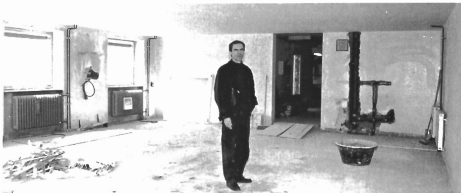
oben: Die neue Decke wird gegossen. unten: Noch fühlt sich Graphiker Michael Wagner etwas verloren in seinem zukünftigen Reich.
