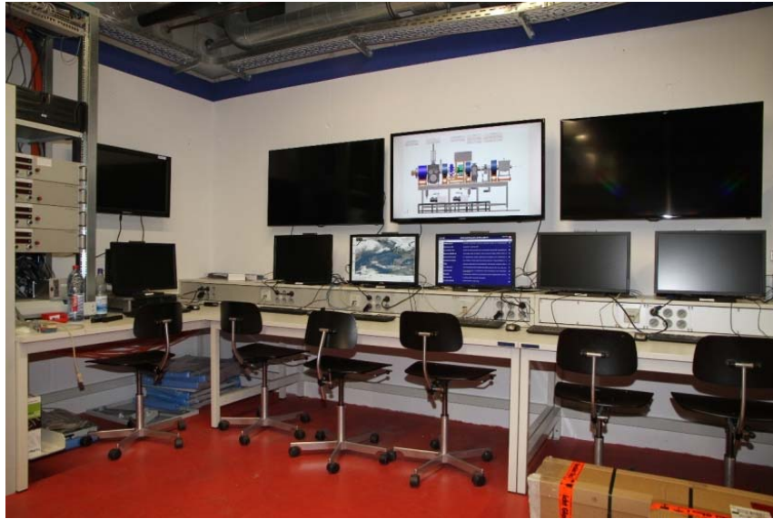
Abbildung 9: Blick in den FRANZ-Kontrollraum.
