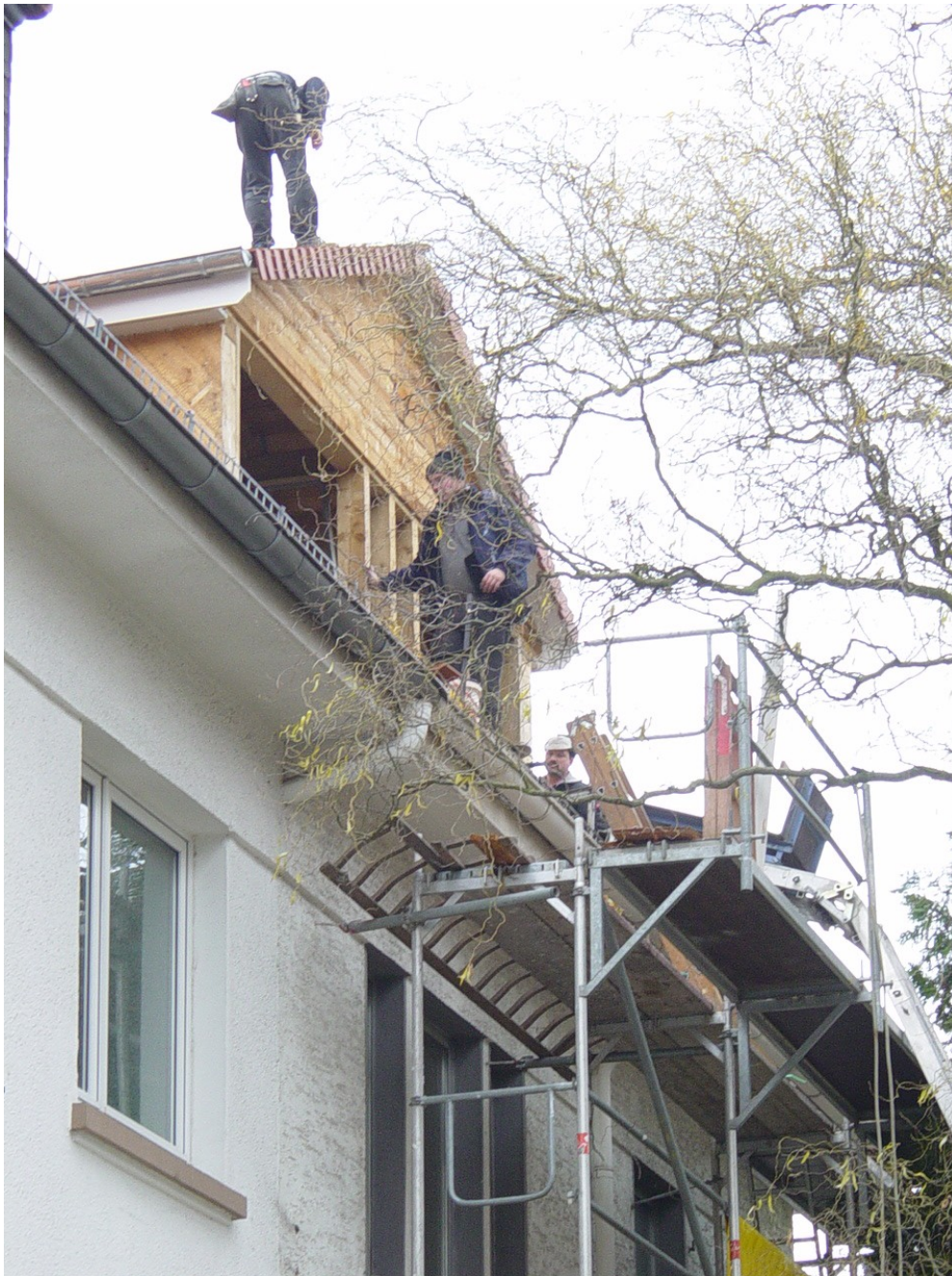
Abbildung 24: Dachdeckerarbeiten an Einfamilienhaus in Nachbarschaft der Autorin (in ca. 8-10m Höhe, zwei ungesicherte Arbeiter, Seitenabsperrung des Gerüstes fehlt)
