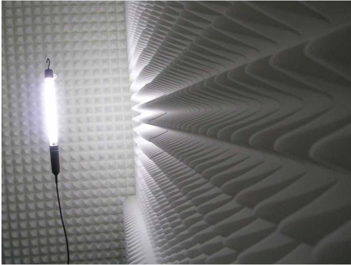
Bild 6.5: Wandauskleidung mit Melaminharzschaumstoff.
