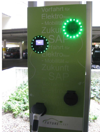
Abbildung 2: Ladesäule an einem Tiefgaragenplatz bei SAP AG Walldorf (Quelle: Deffner)
