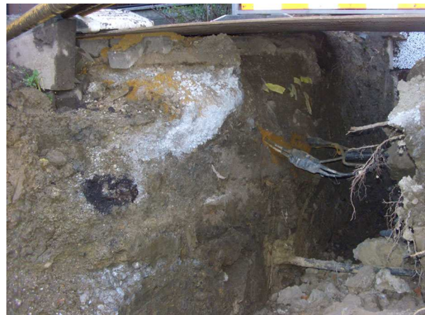
Abb. 2: Arbeiten an Versorgungsleitungen führen zu Bodenumlagerungen und Beimengungen neuer Substrate (2010, T. KASIELKE).
