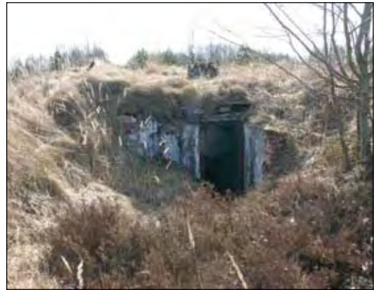
Abb. 132: Sanierungsbedürftiges Winterquartier der Mopsfledermaus. Foto: B. Simon (19.03.2009).
