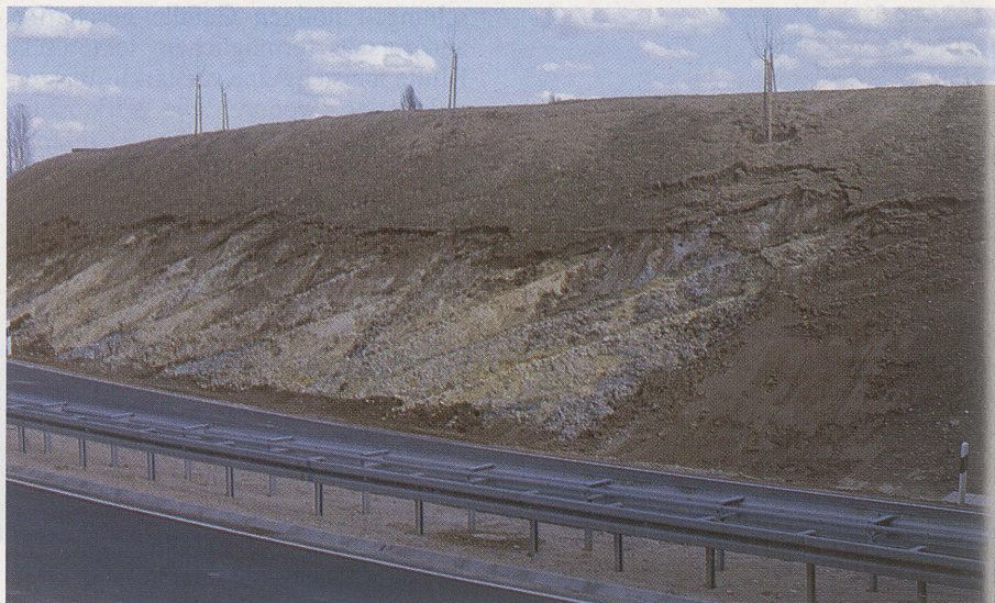
Abbildung 10: Rutschungen an einer Straßenböschung bei Hochheim/Nord. Hier schneidet die neu angelegte Autobahnauffahrt die Grenze zwischen dem pleistozänen Kies und dem darunter liegenden Mergel. Der Mergel ist an seiner Oberfläche durch das im Kies gesammelte Wasser hochplastisch und fließt an der Böschung aus.
