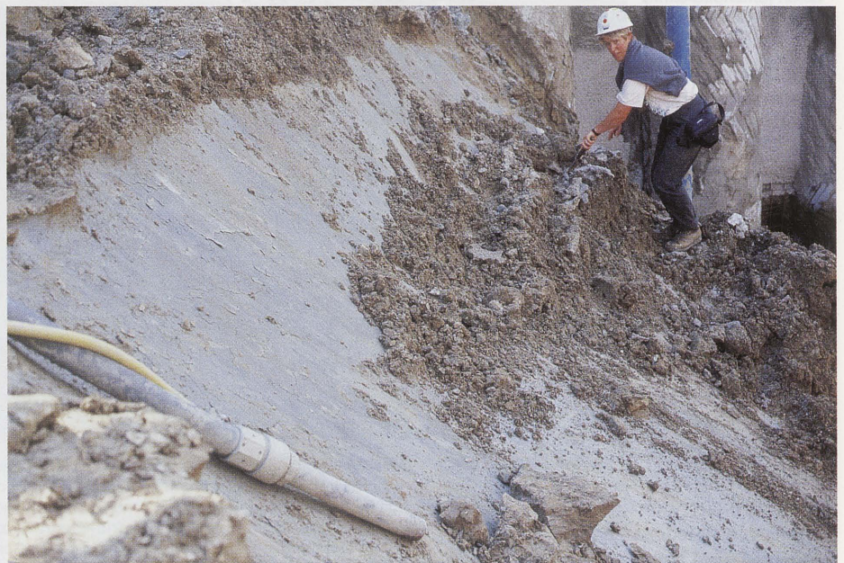
Abb. 5: Freigebagerte Gleitfläche einer Rutschung am Tunnelportal Wandersmann Süd.
