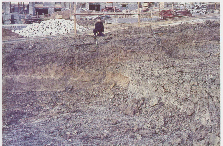
Abb. 7: Schollenrutschungen unterhalb der ICE-Trasse bei Wallau: In einer Baugrube ist rechts grauer tertiärer Mergel angeschnitten, an dem (von der Bildmitte nach links) auf einer Rutschungsscholle Kies, Löss und der darauf entwickelte braune Boden abgesunken sind. Die Scholle drehte sich („rotierte“) hängenwärts, sodass nunmehr der früher parallel zur heutigen Oberfläche verlaufende Boden nach rechts eingesunken ist. Durch die nachfolgende Beackerung wurde ein Gemisch von Mergel, Kies, Löss und Boden über die Schollengrenze hinweggezogen, weshalb die Rutschung heute an der Oberfläche nicht mehr zu erkennen ist („anthropogene Glättung“).
