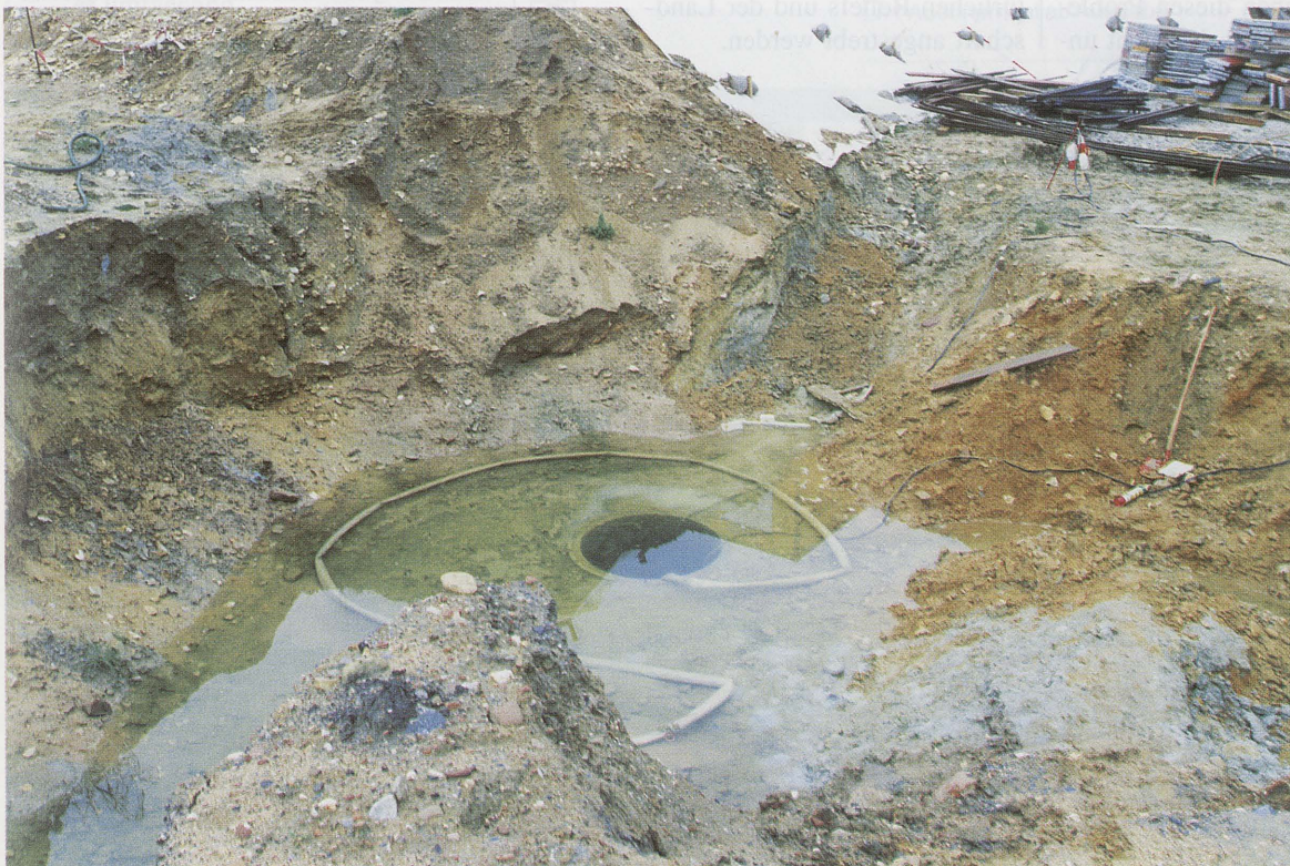
Abb. 10: Grundwasser einbruch in der gleichen Baugrube wie in Abbildung 8 und 9: Das im hellbraunen Kies (linke Bildhälfte) hinter der grauen Mergelaufpressung gestaute Grundwasser lief in die Baugrube, nachdem der Bagger den Mergelwall durchgeschnitten hatte. Die steilstehende Grenze zwischen Mergel und Kies läuft vom Abschöpfbrunnen in der Mitte des Bildes zur untersten Ecke der weißen Plastikplane.
