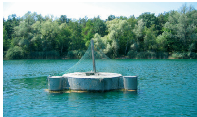
Abb. 2: Gegen Sauerstoffmangel: Tiefenwasserbelüftungsanlage im Waldsee in Forst
