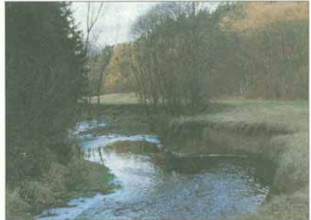
Uferabbruch – Ankauf der Fläche statt Reparatur des Ufers anstreben! (Aufn.: RP Tübingen, Ref. 52)
