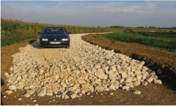
Professioneller Wegebau mit 60 cm Schotterpackung (Wegsicherung in bis zu ein Meter Tiefe). Eine Nasswiese unterhalb eines solchen Weges hat auch in mehreren Dutzend Metern Entfernung keine Überlebenschance mehr, da das zusickernde Bodenwasser vollständig abgefangen wird.
