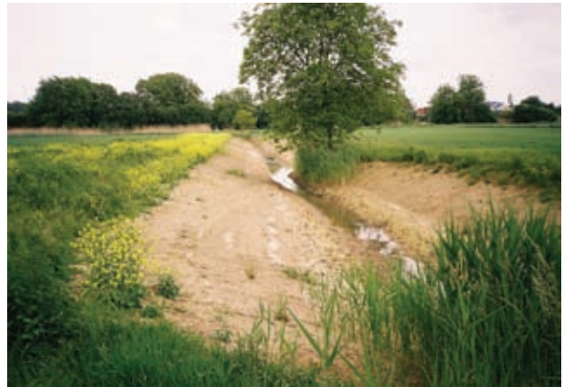
Kleine Ursache – große Wirkung: Mit der Abflachung der Ufer steil eingeschnittener Gräben kann der Erosion und der Grabenverschlammung entgegengewirkt werden. Auch die Pflanzen- und Tierwelt am und im Graben profitiert von solchen Maßnahmen.
