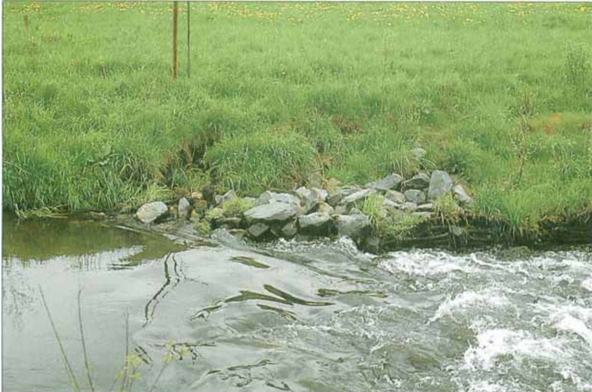
Bild 16: Neuralgischer Punkt bei Sohlrampen: Auskolkungen des Böschungsbereiches, seitliche Einbindung erforderlich, Böschungssicherung durch Bepflanzung
