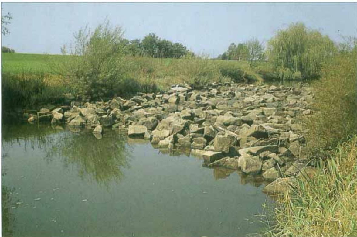
Bild 17: »Steinwüste«: Wegen zu geringer Wasserführung trockengefallene Rampe
