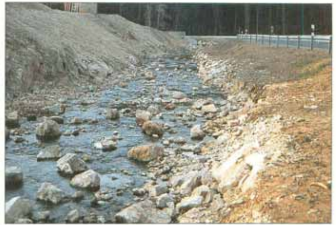
Im Zuge einer Straßenbaumaßnahme verlegtes Gewässer, dessen Sohle mit drei Korngrößen gesichert wurde. Die verwendeten Stützblöcke binden zu wenig in die Sohle ein.
