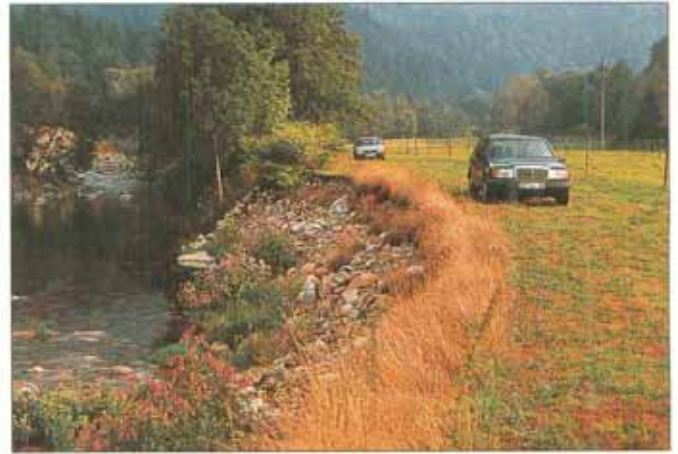
Typischer Hochwasserschaden: Das Stützgerüst der Gewässersohle ist auf größere Länge ausgeräumt und muß neu gebaut werden. Der Uferanbruch selbst sollte mit einer leichten Fußsicherung versehen und dann belassen werden.
