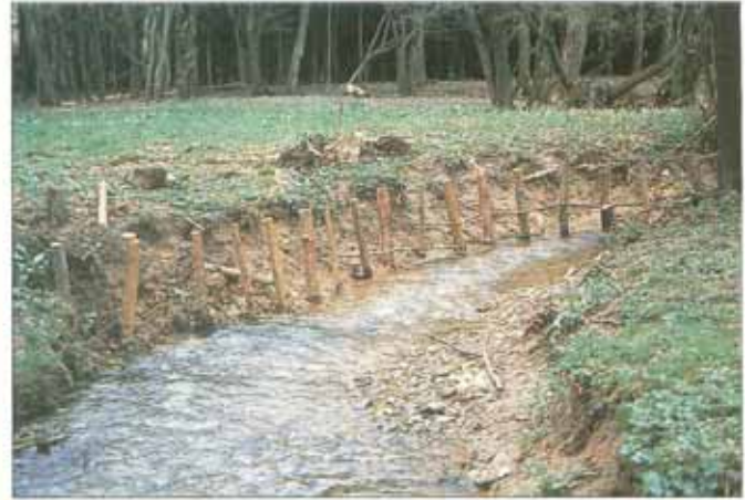
Totholzpfähle längs der Uferlinie im Abstand von ca. 1 m einschlagen, dazwischen zwei lebende Steckhölzer 20 – 30 cm tief stecken.
