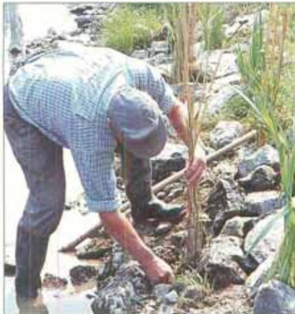
Kombination von Steinschüttung und Röhrichtern. Schwertlilien und Rohrglanzgras wurden als Ballen gepflanzt. Schilf wird durch Halmpflanzung eingebracht.
