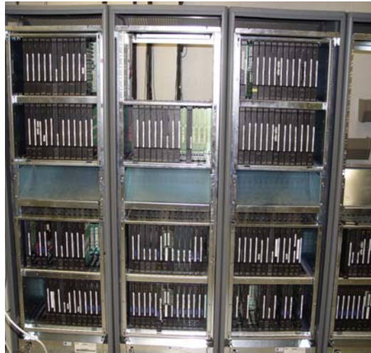
Abb. 2: Telefonanlage Alcatel Enterprise
