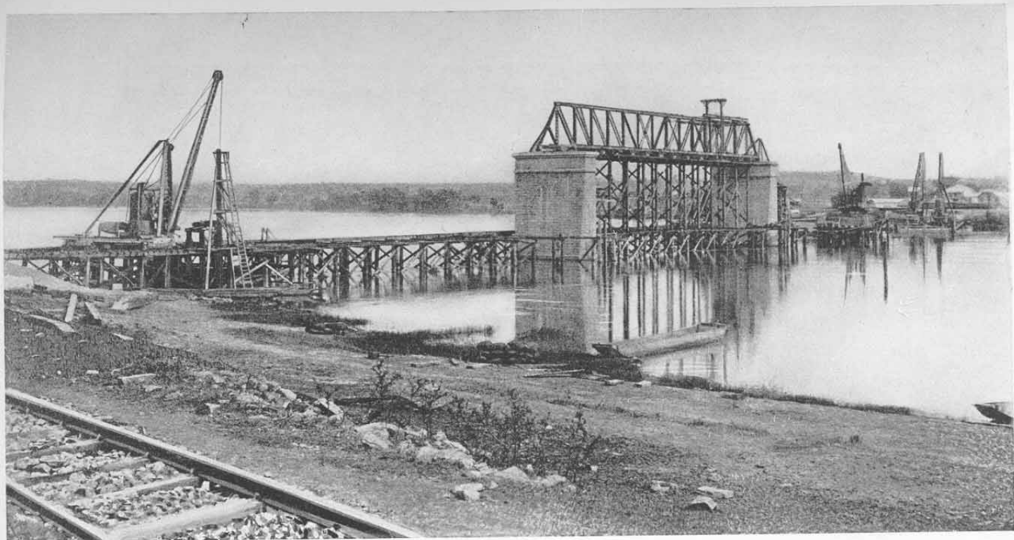
Abb. 60. Brückenbau der Nigerischen Bahn am Niger bei Jebba; Südarm. Stand am 1. März 1913. Blick nach Osten.
