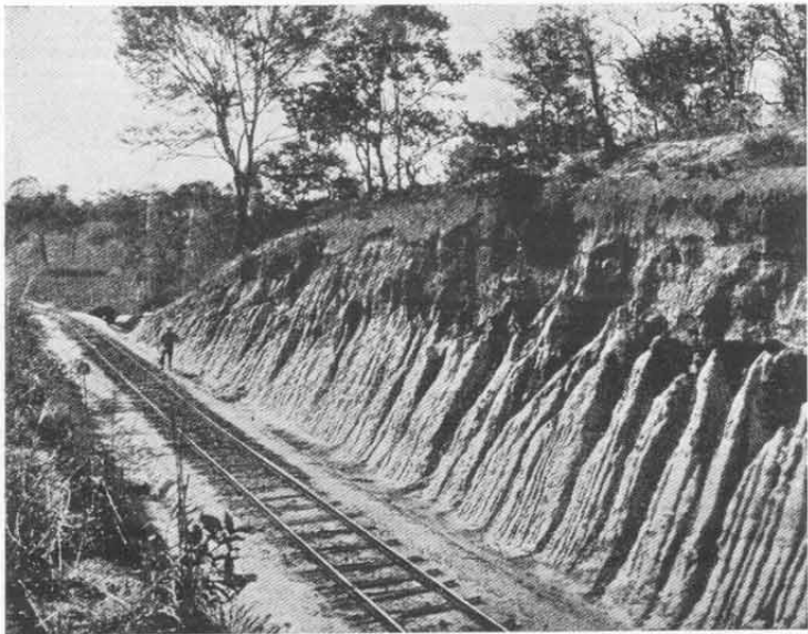
Abb. 81. Einwirkung des Regens auf die Böschungen. Tanganjikabahn.
