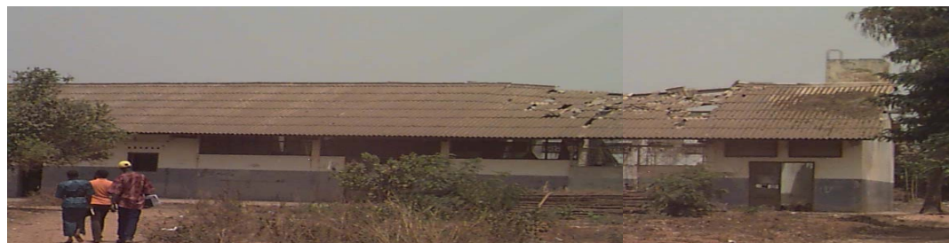
Armazém de Centro de Próteses destruído
