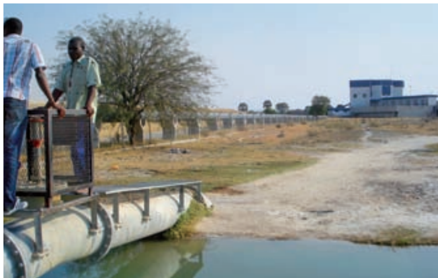
Fernwasserversorgung in Namibia: Zwei Mitarbeiter der städtischen Trinkwasserwerke von Oshakati begutachten eine Leitung, die Wasser aus dem Kunene, dem entlegenen Grenzfluss zu Angola, in die wasserarme Region transportiert.
