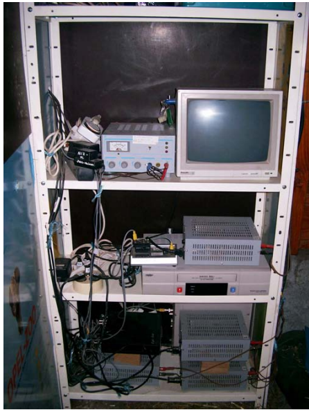
Abb. 12 Aufzeichnungseinheit (Opel-Zoo) bestehend aus Zeitraffer-Videorekorder und Quadrantenteilern, Netzgeräten zur Stromversorgung und Überwachungsmonitor
