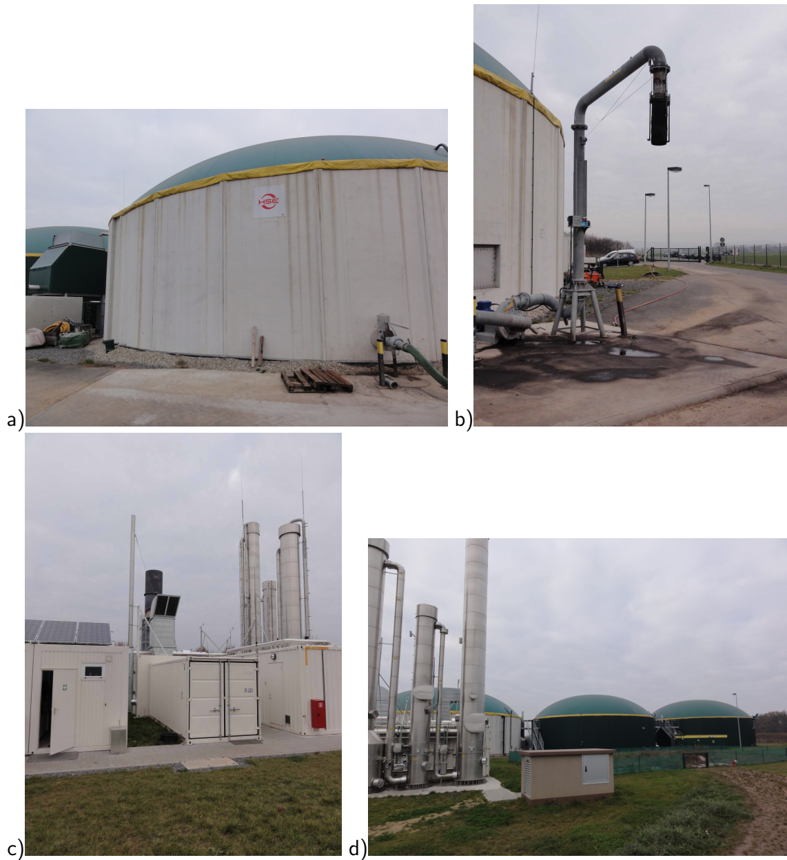
Abbildung 3.4.3: Bilder der Biogasanlage Semd (Teil 3): a) Gärrestlager b) Abfüllanlage für Gärreste c) Gasaufbereitungsanlage d) Biogasanlage Semd (Quelle: HSE AG).
