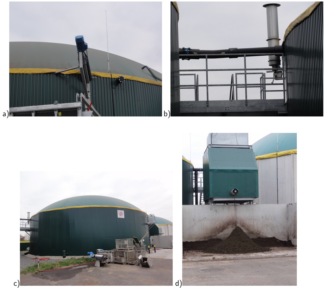
Abbildung 3.4.2: Bilder der Biogasanlage Semd (Teil 2): a) Rührwerk am Fermenter b) Verbindungsrohr zwischen Fermenter und Nachgärer, Notfackel c) Nachgärer d) Separator (Quelle: HSE AG).
