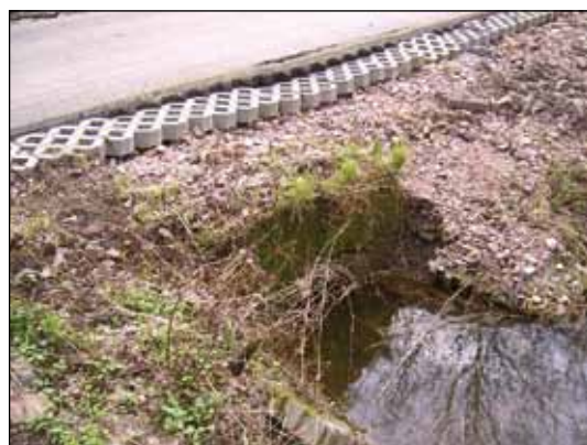
Abb. 2: Erosionsschäden an kleindimensionierten Durchlässen in verbauten Flutrinnen am Siebeneichenweg im September 2005. Foto: U. Patzak.
