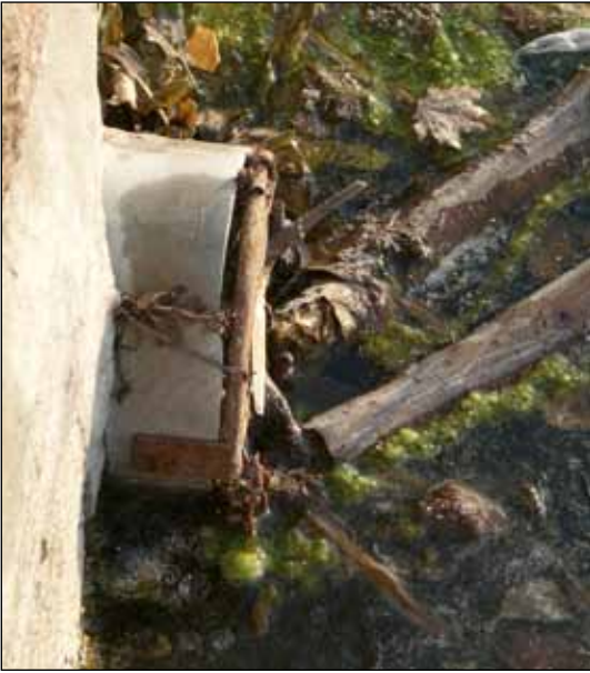
Abb. 2: Auslaufrohr des Dorfteiches mit Schwemmgut. Foto: W. Wendt.
