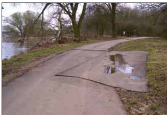
Abb. 1: Vom Hochwasser erodierter Asphaltbelag des Siebeneichenweges bei Dessau Großkühnau im November 2004. Foto: U. Patzak.
