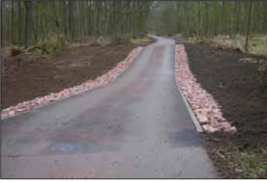
Abb. 3: Absenkung des Siebeneichenweges im Bereich einer Flutrinne im Dezember 2007. Foto: A. Eichhorn.
