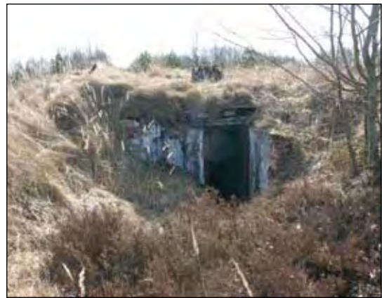
Abb. 132: Sanierungsbedürftiges Winterquartier der Mopsfledermaus. Foto: B. Simon (19.03.2009).
