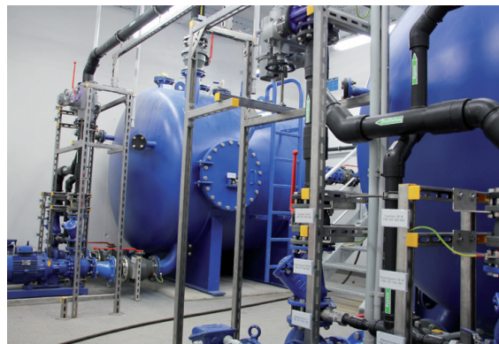
Abbildung 2: Vakuumsstation in der Jenfelder Au. Mehr als 700 Haushalte werden hier an den HAMBURG WATER Cycle® angeschlossen, um das Abwasser als vielfältige Ressource zu nutzen. (Quelle: HAMBURG WATER)
