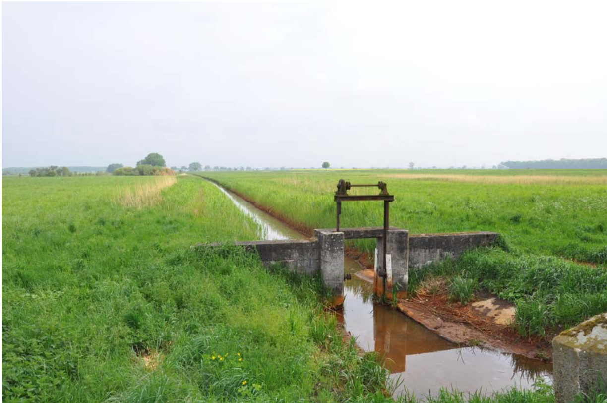
Abb. 3: Blick in einem ungeräumten Grabenabschnitt des Scheidgrabens. Zu erkennen ist die starke Verlandung des Grabens, 28. März 2011, Foto Egbert Korte – View of an uncleared ditch (Scheidgraben), showing considerable mud deposits, 28 March 2011.
