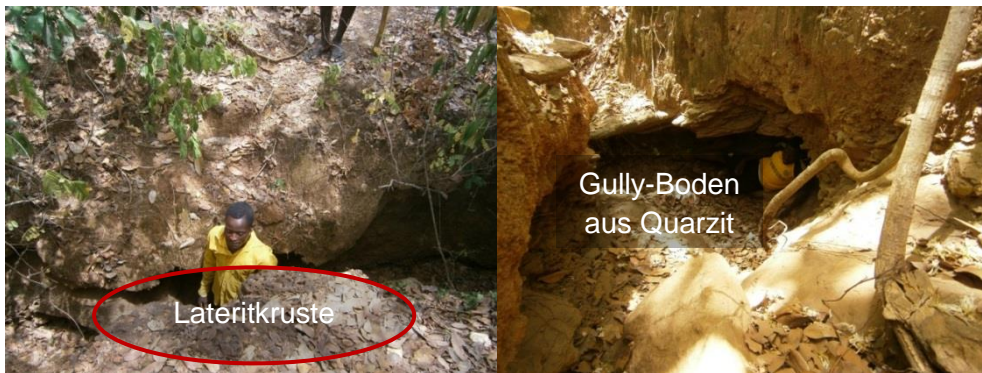
Abb. 5.7: 1,6 bis 2,5 m tiefes inaktives Gully-System und Abspülungen im Unterboden (Piping) im Dorf Dikouan (Fotos: Anoumou 2015)
