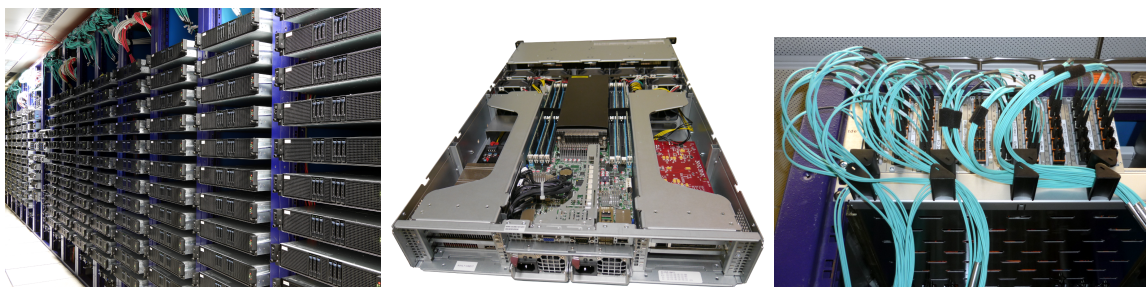
Abbildung 2: Links: Foto des ALICE HLT Clusters zu Beginn von RUN 2. Mitte: Offener HLT Rechnerknoten mit C-RORC in rot. Rechts: Optische Aufteilkabel zur Glasfaster-Installation.
