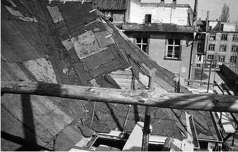
Notdach über der alten Kinderklinik, Zustand 1946 (Quelle: Sammlung Hosemann, Dr. Senckenbergisches Institut für Geschichte und Ethik der Medizin, Frankfurt am Main).
