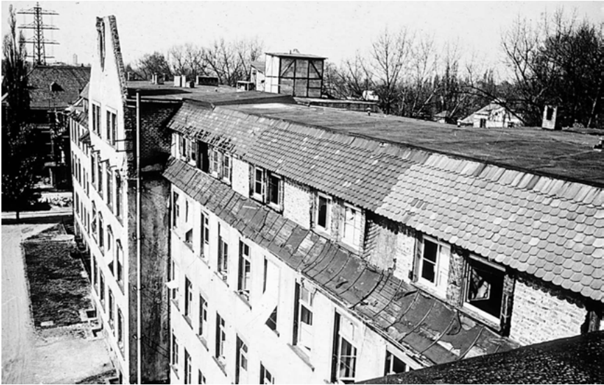
Die notdürftig instandgesetzte Frauenklinik, Südostfassade, 1947 (Sammlung Hosemann).
