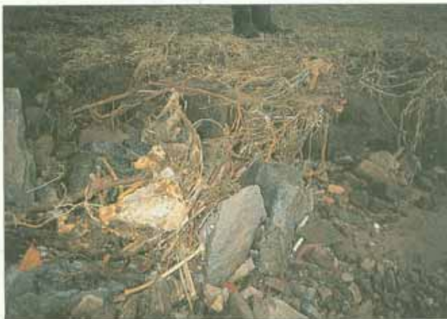
Abb. 11: Als eine Ursache können die freigelegten Rhizome und Wurzeln des Japan-Knöterichs (hier im Bereich des Mittelwasser-Pflasters) angesehen werden, dessen geringer Feinwurzelanteil das Bodenmaterial nicht ausreichend festzuhalten vermag. Stellenweise wurden durch die Knöterich-Wurzeln Pflastersteine aus dem Verband gelöst.
